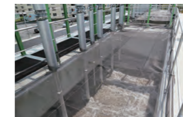
■ 水処理プラント 産業排水処理システム
