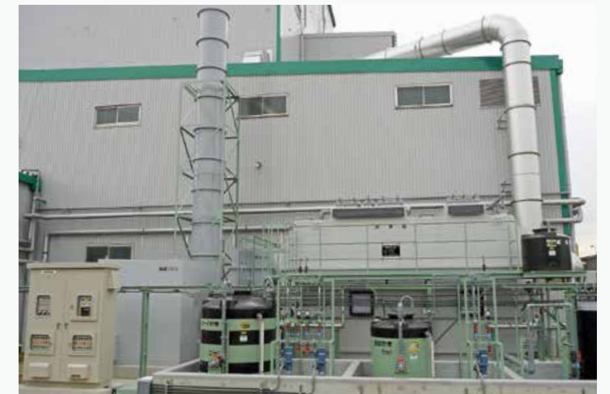
横型薬液洗浄塔
