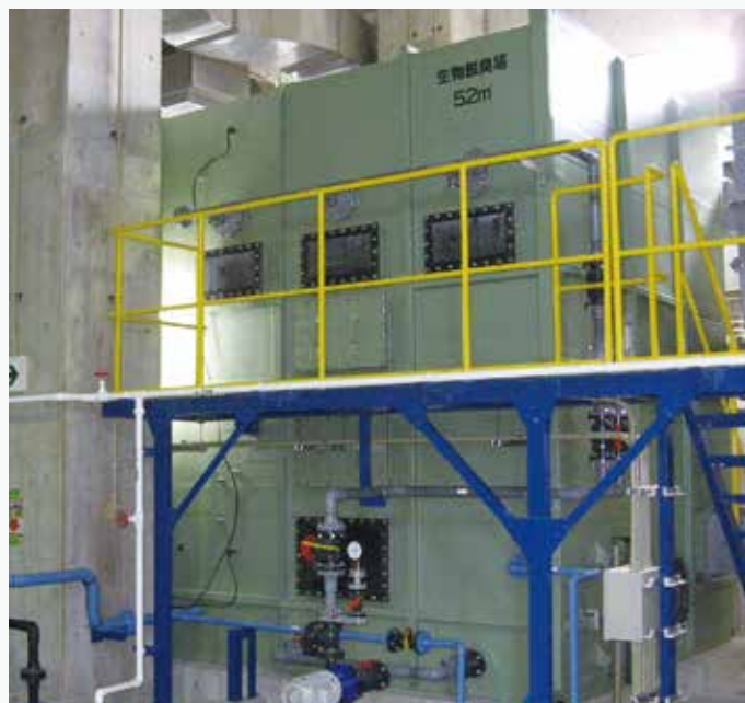
横型2塔一体型生物脱臭塔
