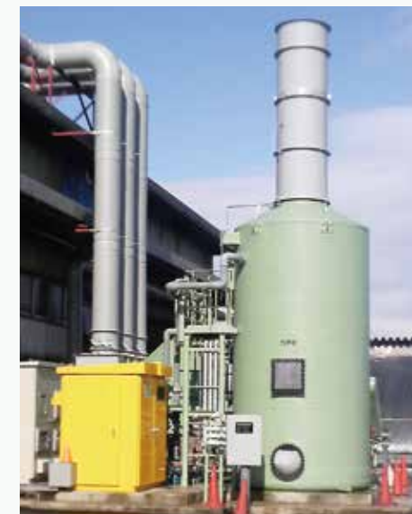
立型薬液洗浄塔
