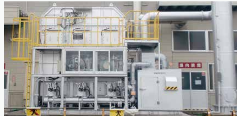
蓄熱式燃烧脱臭装置
