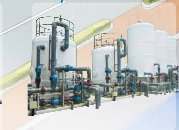
P.4 >>> FRP製のろ過機
